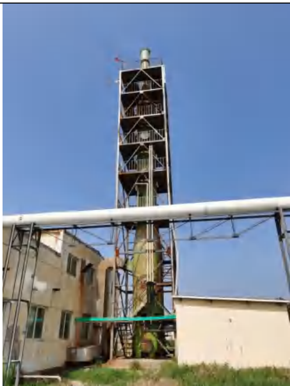
备用锅炉排气筒
