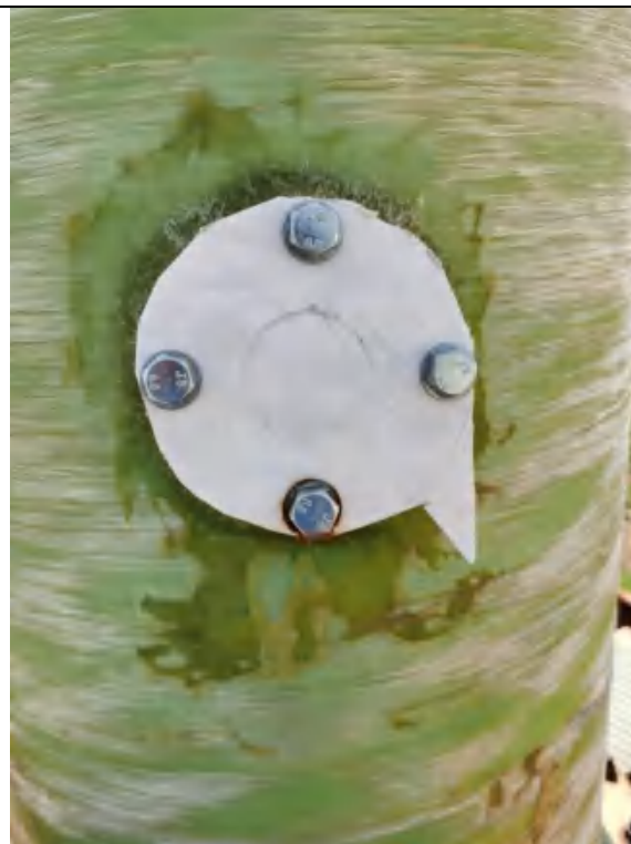
沼气锅炉排气筒 DA002 采样口
