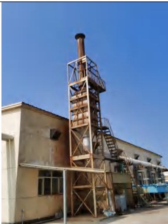
发电机房排气筒 DA003
