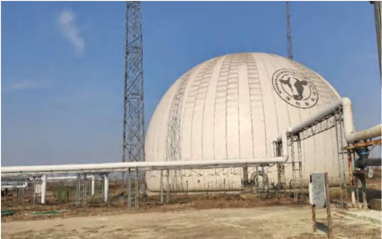
沼气球储存现场图
