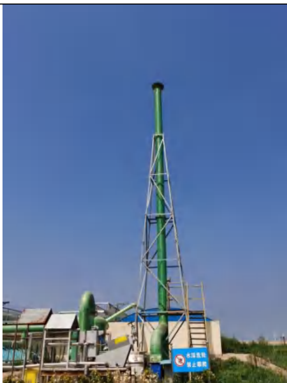
污水处理站废气处理设备及排气筒 DA005
