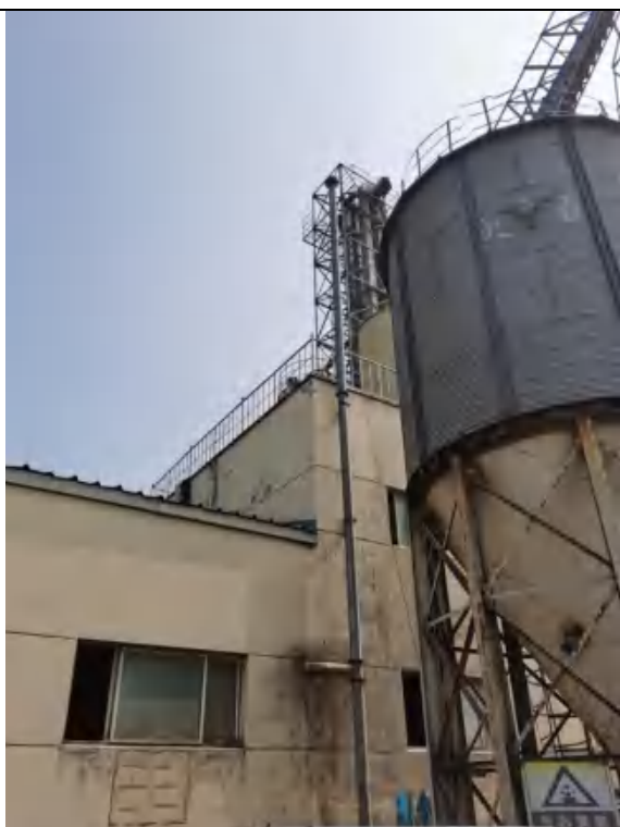
饲料加工排气筒 DA001
