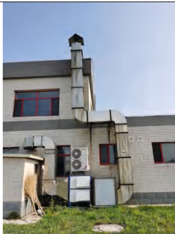
食堂排气筒 DA004
