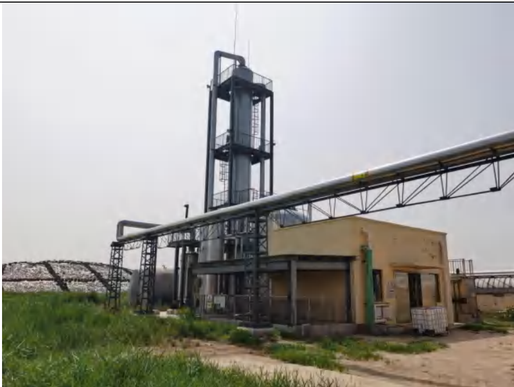
脱硫塔现场照片
